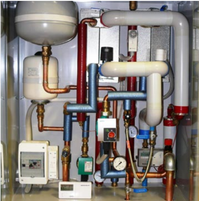
Węzeł kompaktowy w szafce o wymiarach 0,9×1×0,45 m
